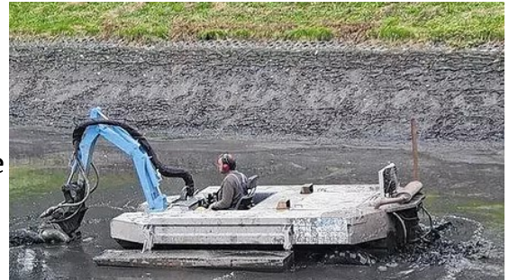
Foto: Andrea Kemmer | Aufwühlender Job: Eckhard Funck quirlt den Schlamm im Becken der Kläranlage Neubrunn mit seinem Amphibienfahrzeug auf, um ihn dann abzusaugen.
